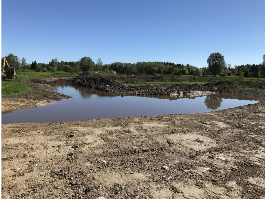
Bild 2 Hälften av grunddelen schaktad. Foto taget från inloppet i sydväst mot nordost 210528.
