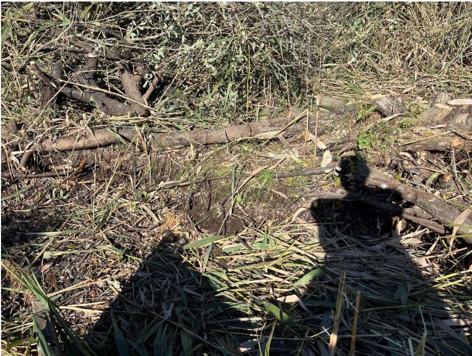
Bild 5-6. Bilder på gamla dämmet, som läckte vid flera plankor, samt att det på västra sidan (nedre bilden) hade skurit sig runt i en knappt 2 m bred ränna med en botten som var lika låg som botten på V-et i Thomsomöverfallet.
