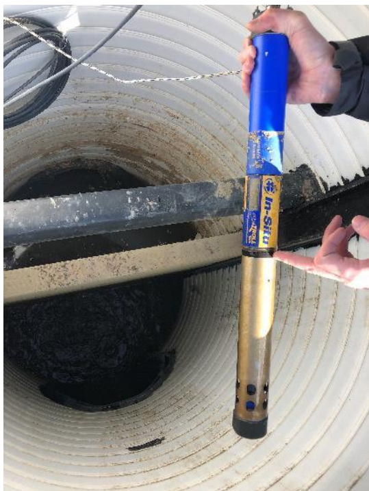
Figur 7. Självrengörande turbiditetsmätare i brunn i anslutning till provtagningsplatsen vid inloppet till Gottsunda dagvattenpark.
