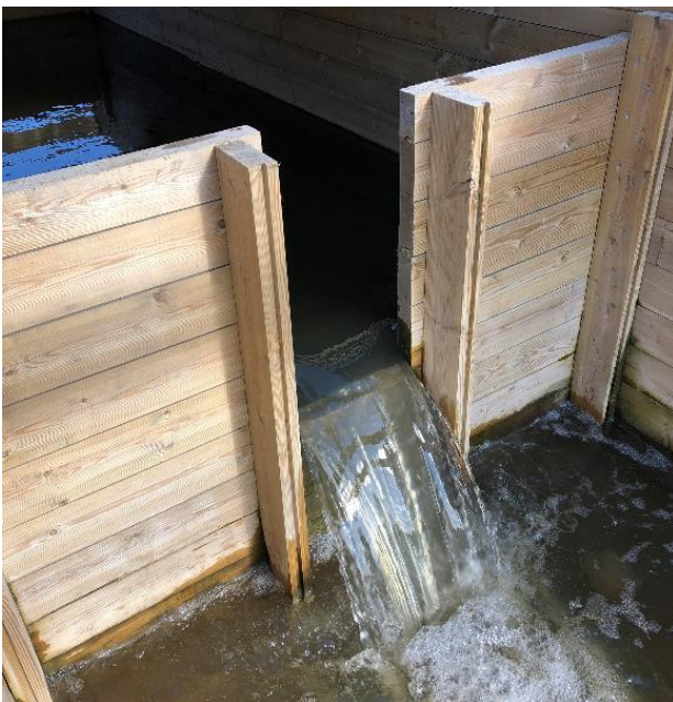
Figur 6. Mätöverfall i träränna vid utloppet från försedimenteringsdamm B, Gottsunda dagvattenpark.
