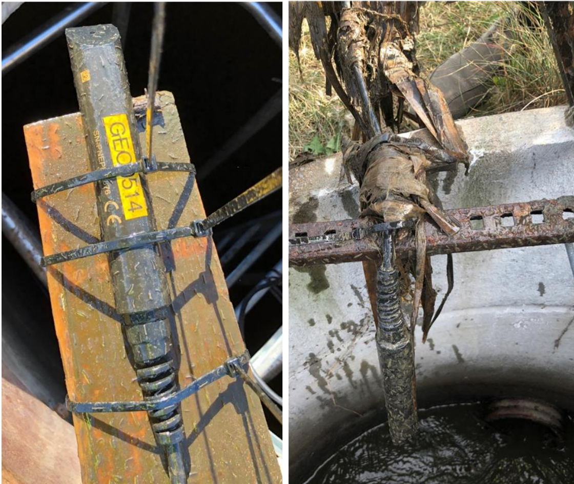
Figur 12. Rengöring av turbiditetsgivarna i Kungsängsdammen t.v. 19 maj och t.h. 16 augusti i utloppet.
