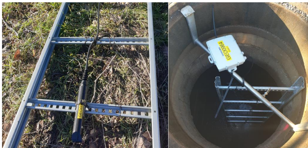
Figur 6: Figurerna visar installationen av mätsensor och logger, exempel på installation vid Svartbäcken. (Ahlström 2021).
