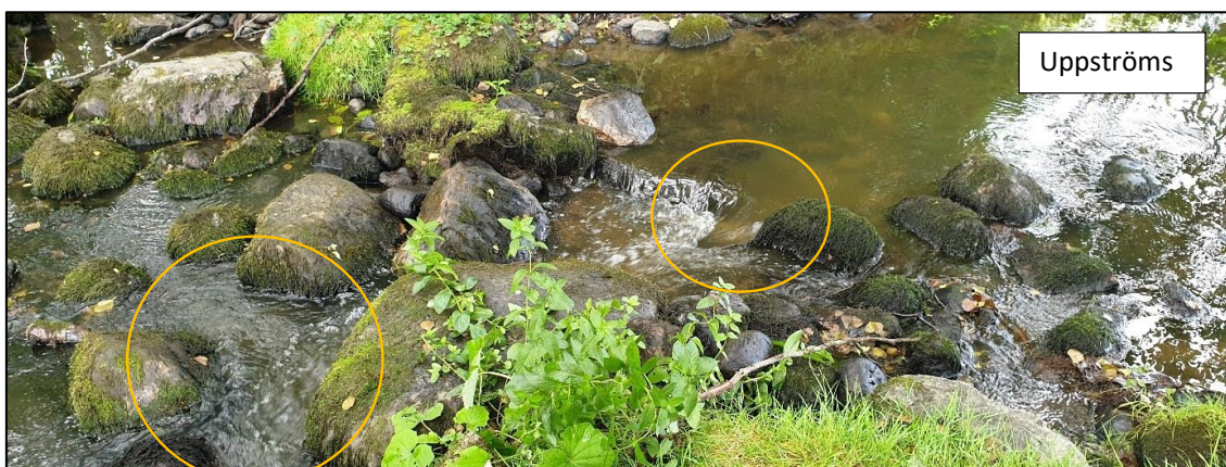
Figur 3a. Bilden markerar åtgärder vidtagna vid Ensta dämme i öppning 1. Foto: Anders Larsson, Tyréns.
