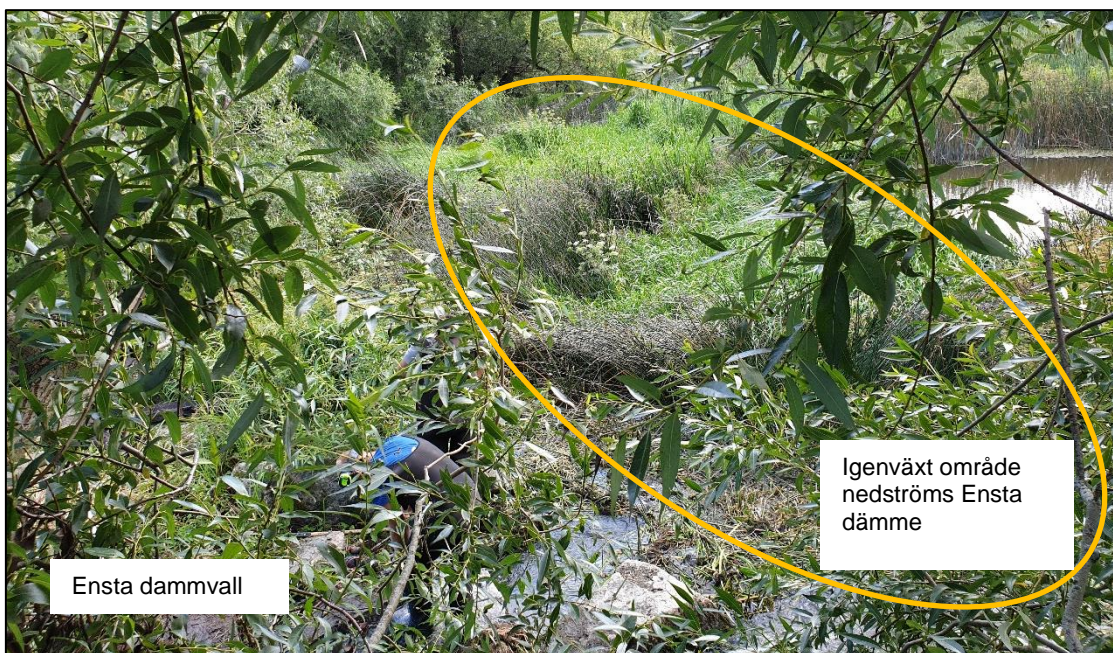
Figur 8. Foto som visar omfattningen av igenväxningen nedströms Ensta dämme. Bilden är tagen vid öppning 2 i riktning mot öppning 4. Foto: Anders Larsson, Tyréns.
