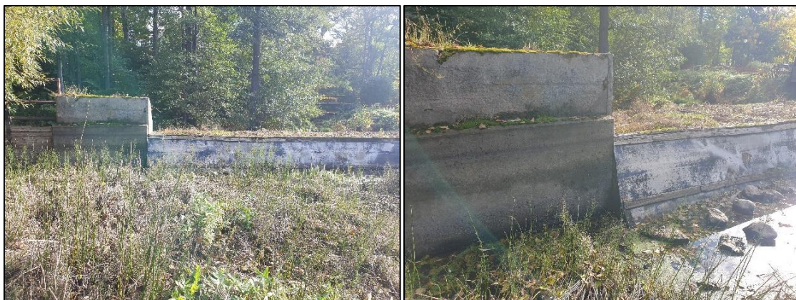
Figur 11. Tidigare tätningsåtgärder med ny betong och en "tätningsduk" under skibordet Foto: Anders Larsson, Tyréns
